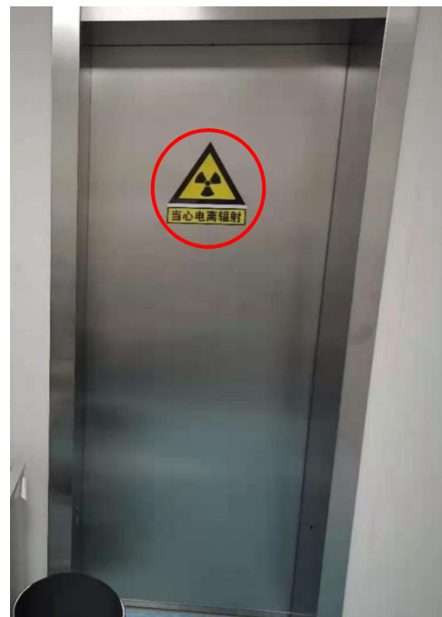
图 4-3 DSA 机房工作人员入口防护门
