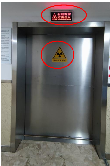
图 4-2 DSA 机房患者入口防护门
