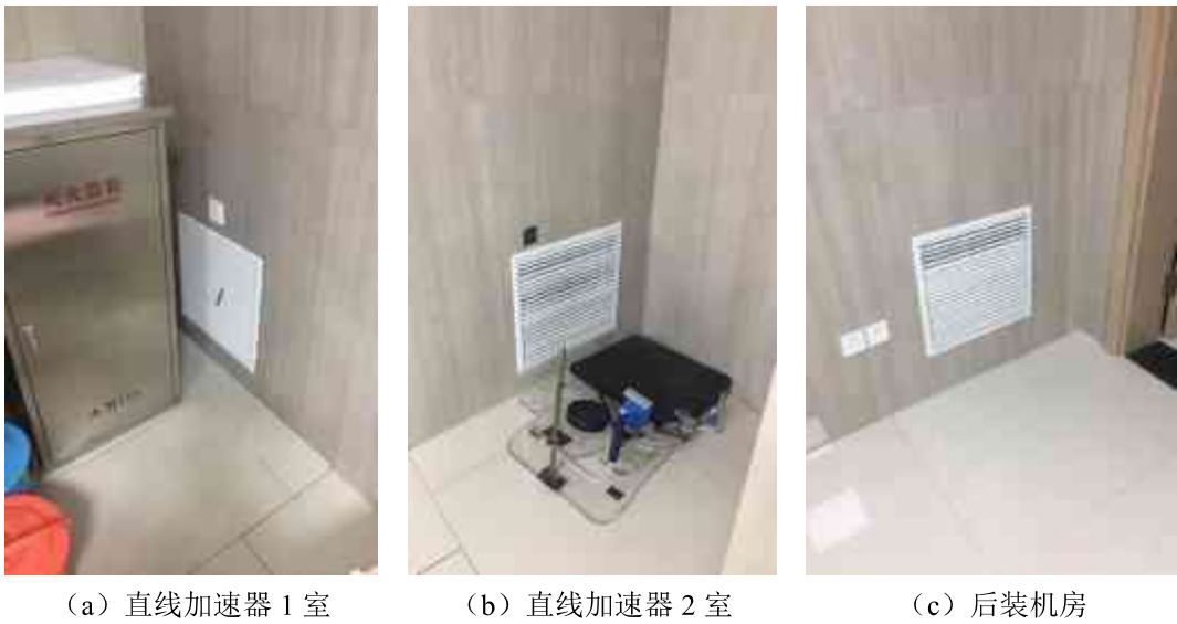
图 4-8 机房内通风装置
