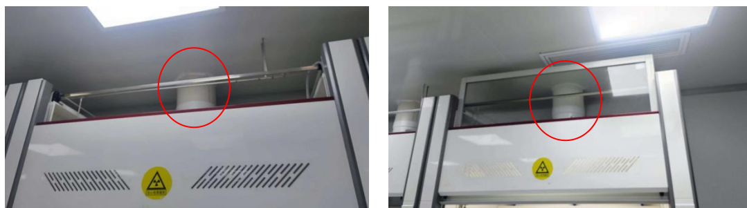
通风橱独立排风管
