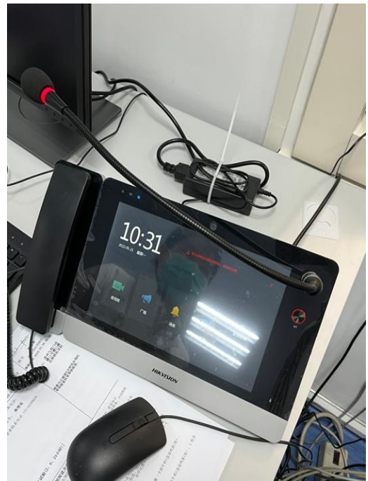
控制室对讲装置
