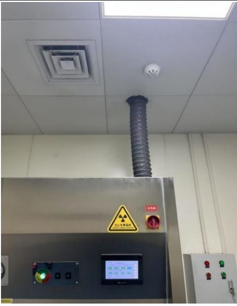
手套箱通风管道
