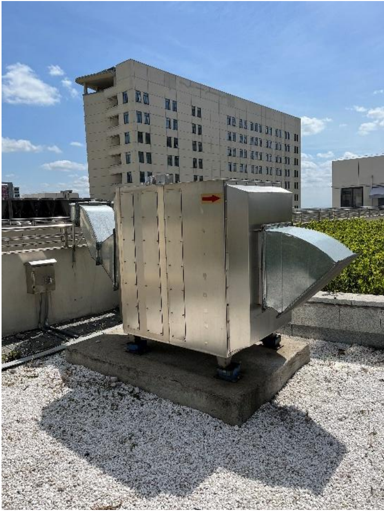
核医学工作场所楼顶部排风口
