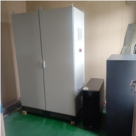
伽玛刀机房西侧设备间
