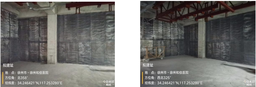
图 8-1 本项目 DSA 机房拟建址
